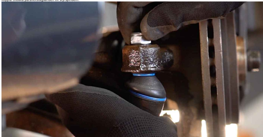
18 Skruva åt fästande skruven som kopplar styrstagsände till styrspindel. Använd hylsnyckel Nr17. Använd en momentnyckel. Dra åt den till 33 Nm vridmoment.
